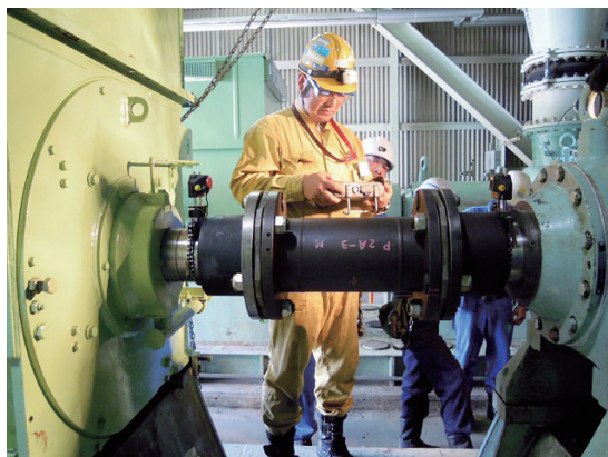
写真1 吸収塔循環ポンプ
